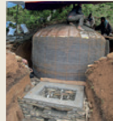
Tangle: Wassertank mit Anschlüssen in der Bauphase
